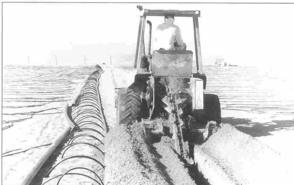
صورة ٨/٣. مزرعة نموذجية كاملة التجهيز، وفي الصورة معدة زراعية تقوم بالحفر لتجهيز شبكة ري حديثة في مزرعة أحد المواطنين في المنطقة الشرقية من إمارة أبوظبي.
